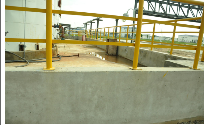
VCM 乙炔气柜/单体气柜
