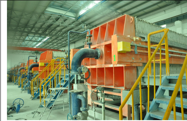
电石渣浆处理系统
