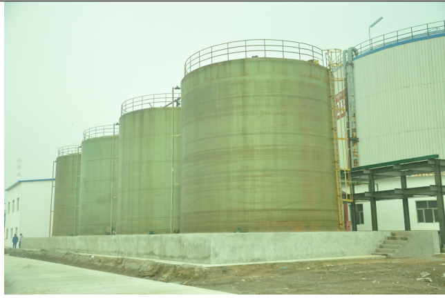
盐酸烧碱储罐
