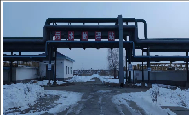
污水处理设施
